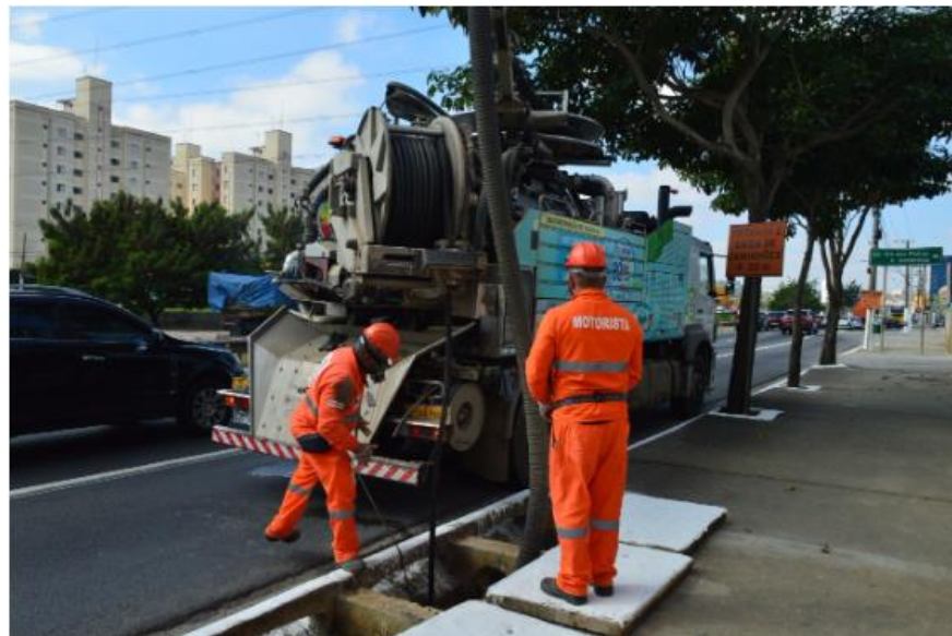
Legenda: Exemplo de Serviço de Microdrenagem.
